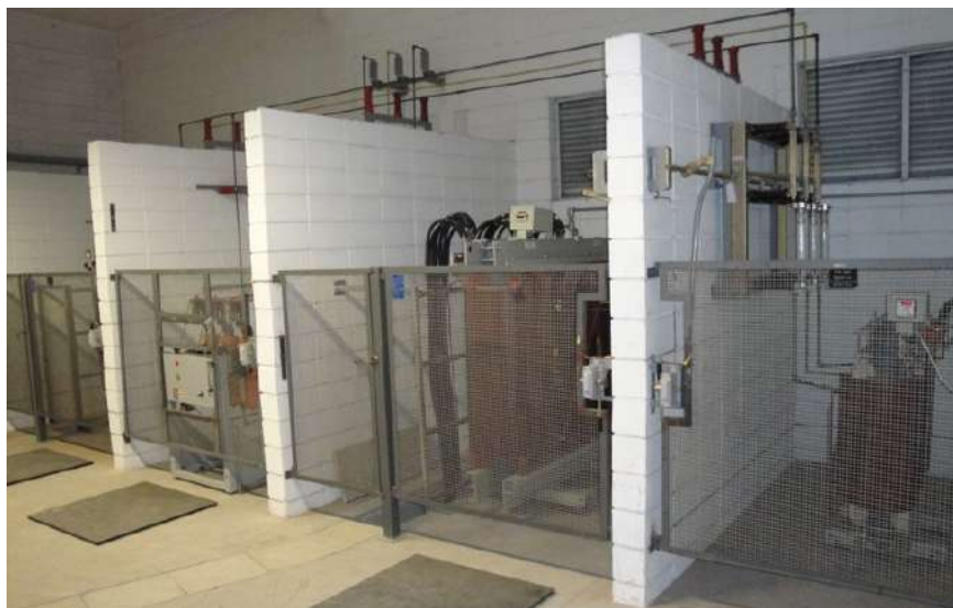
Figura 3 - Instalação de uma subestação abrigada
