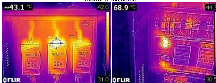
Figura 8 – Retrato termográfico dos pontos críticos no Soft Starter e Disjuntor.
