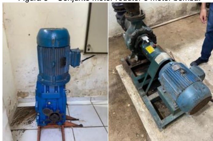
Figura 6 – Conjunto motor redutor e motor bomba.
