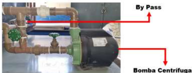
Figura 2 – Sistema bombeamento com recirculação.
