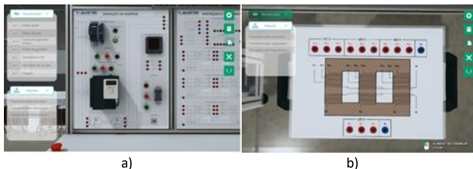
Figura 4 – Visual do LV3, a) Quadro da bancada principal, b) Transformador.
