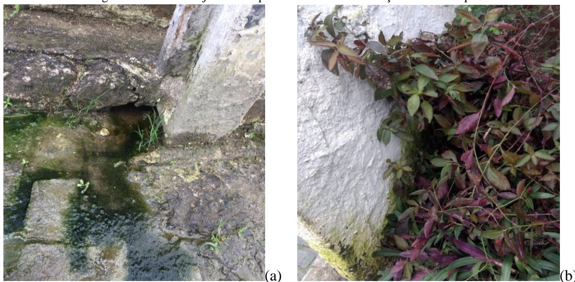
Figura 3: Abertura adjacente ao passeio da obra e infiltração na base da parede
