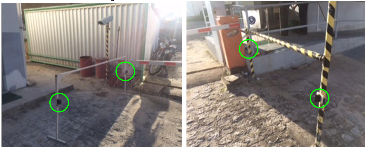
Figura 4 – Sensores instalados no local de controle
