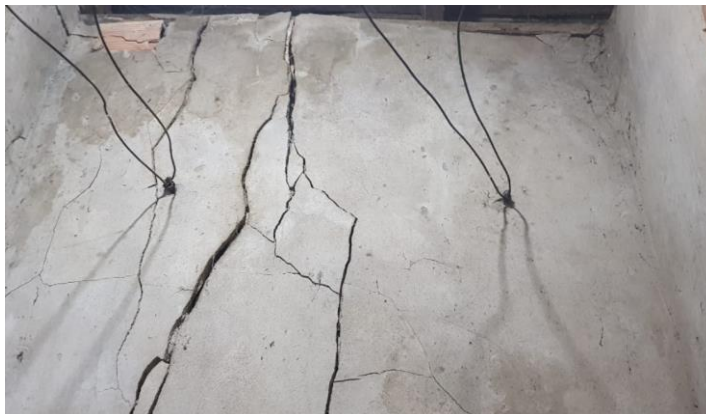
Figura 5 – Estrutura comprometida no banheiro de uma das casas.
