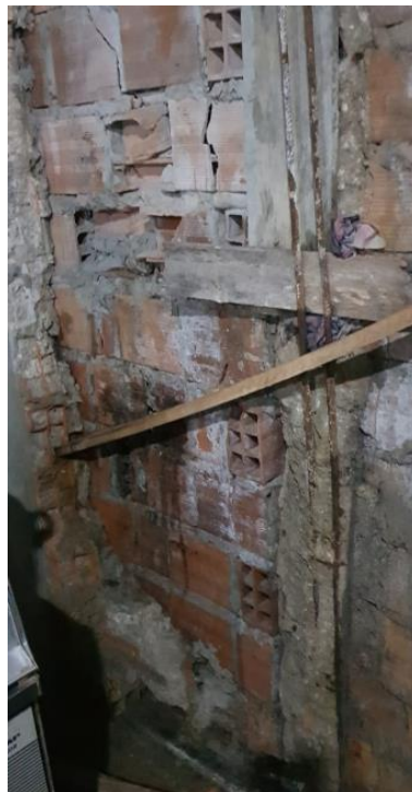
Figura 6 – Improvisação feita por uma das partes visando conter os riscos de ruína.
