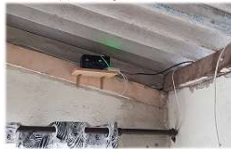
(b) instalação interna.
