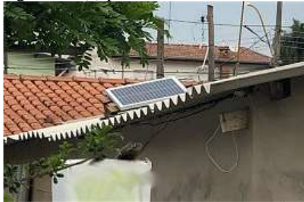
Figura 3 – (a) placa solar externa;
