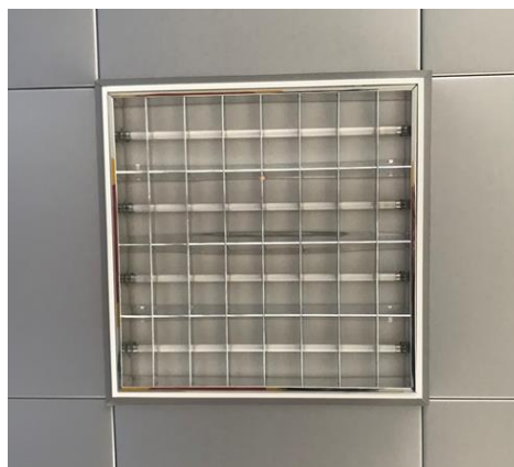
Figura 1 - Luminárias do Prédio Nikola Tesla
