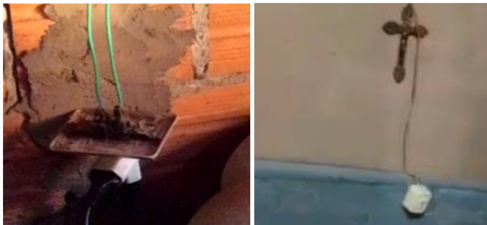
Figura 4 – Tomada exposta e interruptor sem fixação.
