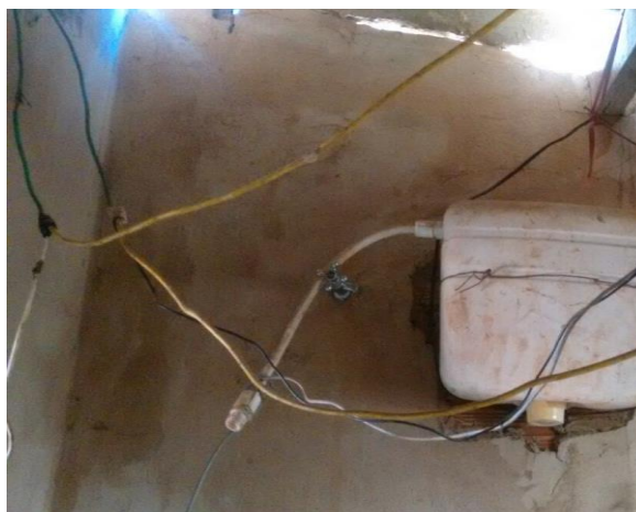
Figura 7 – Fios desencapados próximos a locais com água.
