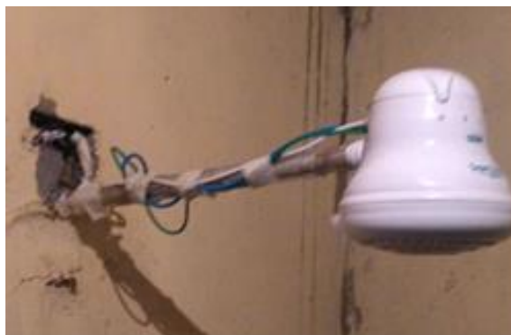
Figura 2 – Instalação precária de chuveiro elétrico.
