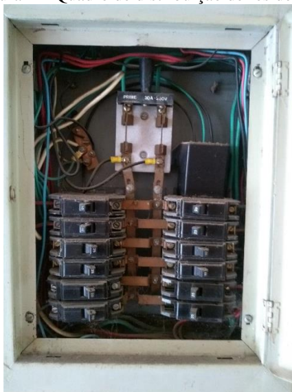
Figura 1 – Quadro de distribuição de residência.
