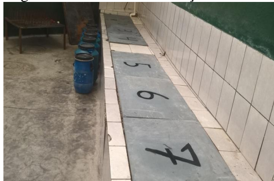
Figura 3 – Caixas de decantação.
