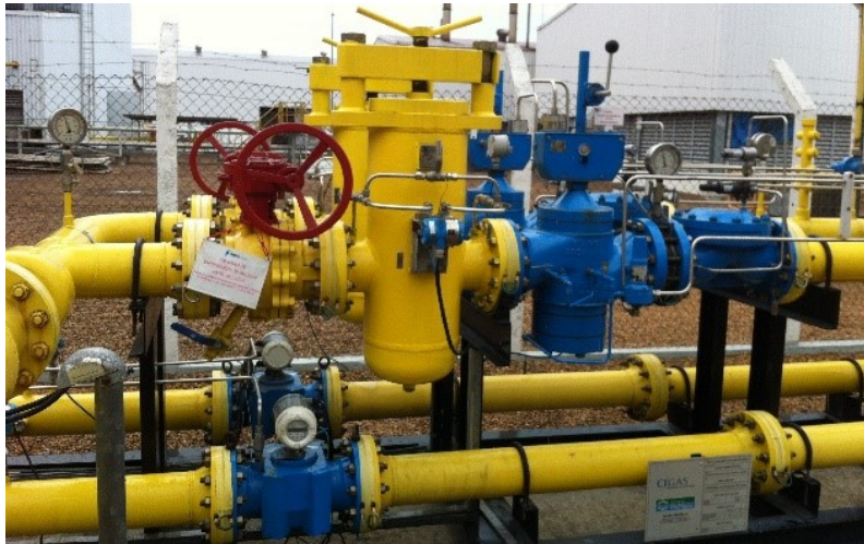
Figura 2 – EMRP instalada em uma usina termoeletrica.
