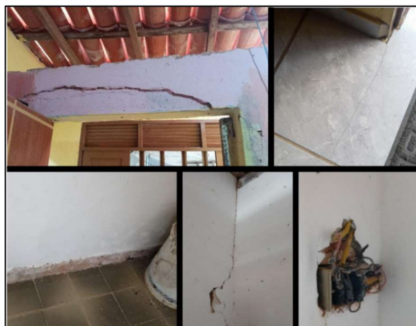
Figura 4 – Exemplos de patologias construtivas encontradas nas residências vistoriadas.
