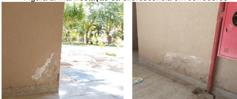
Figura 2: Manifestação da eflorescência em corredores
