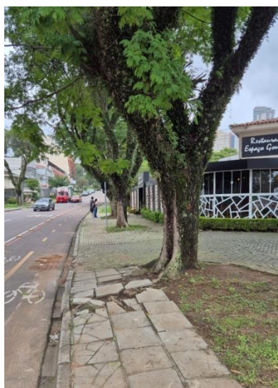
Figura 2 - Calçada quebrada em função do crescimento das raízes de uma árvore
