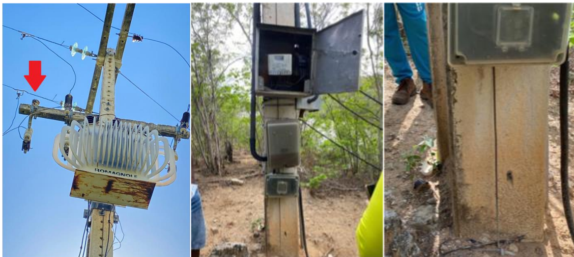
Figura 5 – Não conformidades encontradas durante a visita técnica.
