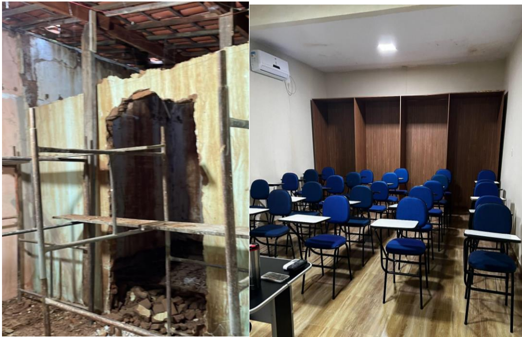
Figura 6 – Local do Laboratório (a) Reforma estrutural da sala onde será instalado o laboratório; (b) Resultado da reforma do laboratório.
