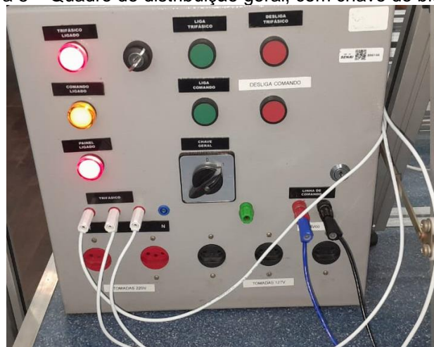
Figura 5 – Quadro de distribuição geral, com chave de bloqueio
