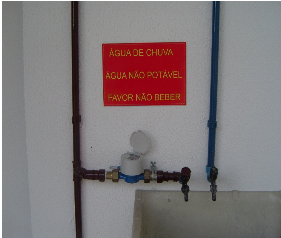
Figura 4 – Hidrômetro e tubulações de água fria potável (azul) e água de chuva (marrom).
