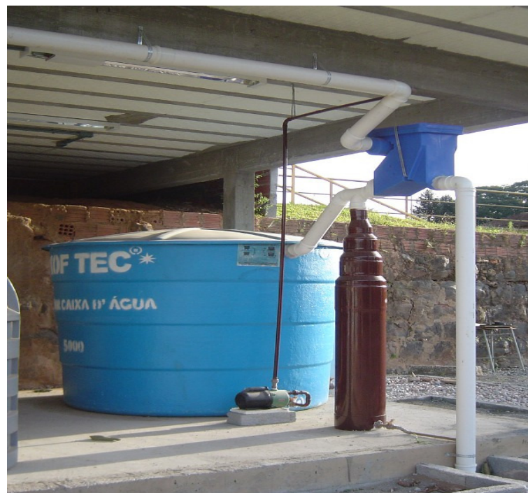
Figura 3 – Sistema de gradeamento, reservatório de descarte e reservatório de armazenamento de água de chuva da Casa Modelo.
