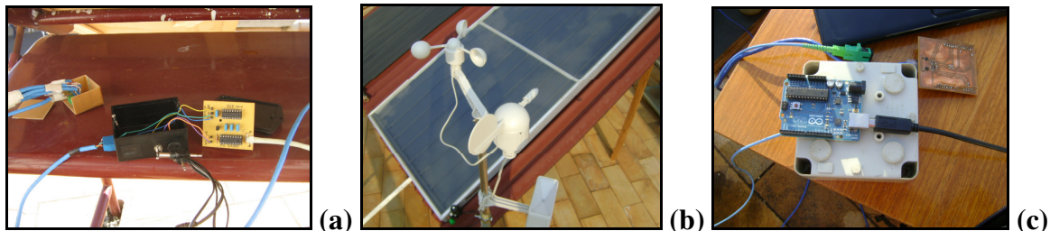
Figura 3 – Sistema de aquisição de dados dos aquecedores solares. (a) Placa controladora dos sensores de temperaturas. (b) Solarímetro e Anemômetro instalados ao lado dos coletores. (c) Placa Arduino para leitura dos dados de irradiação solar e velocidades de ventos.
