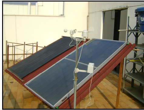
Figura 2 – A bancada de ensaios em seu formato final com os coletores solares, o reservatório d’água e os dispositivos de aquisição de dados.
