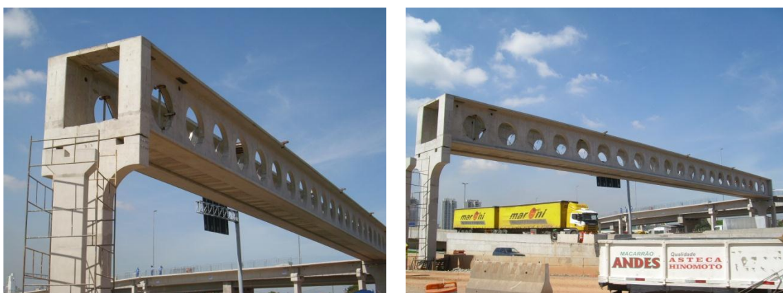
Figura 4 Vigas celulares de uma passarela sobre a Rodovia Anhanguera Fonte: Acervo pessoal.
