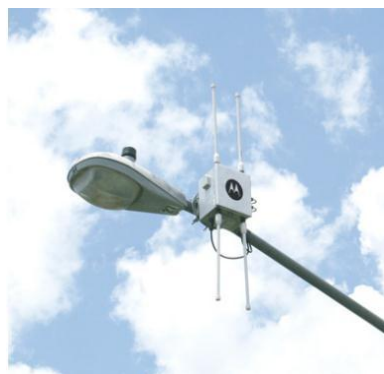
Figura 3 – Ponto de acesso em um poste de luz.
