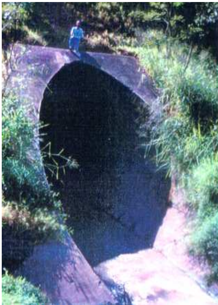
Figura 3 – Bueiro de travessia sob FERROBAN em Lins – primeiro autor ao topo da foto (Fonte: Caldato, 1999)
