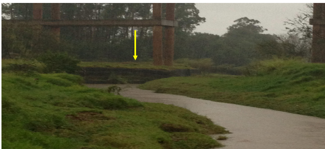
Figura 9 – Proteção das margens sob a ponte por gabiões – providenciada após erosão.
