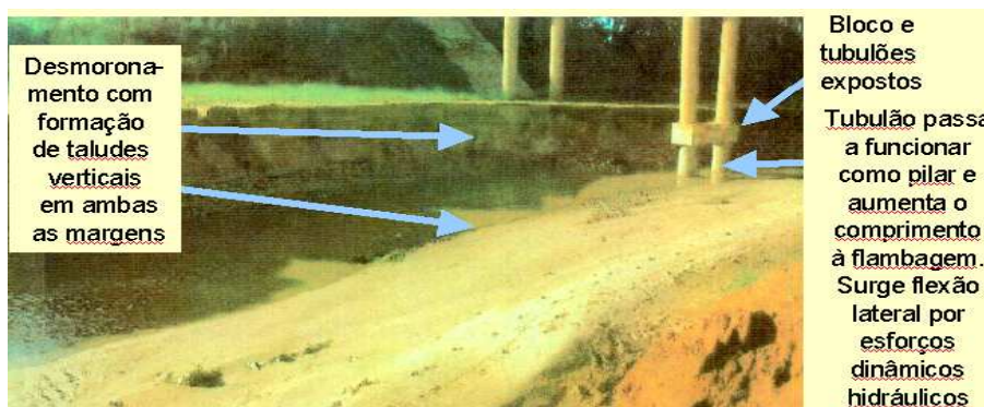
Figura 8 – Canal após erosão. Margem direita: pilares e bloco exposto. Margem esquerda: aterro ferroviário próximo aos pilares e à margem erodida.
