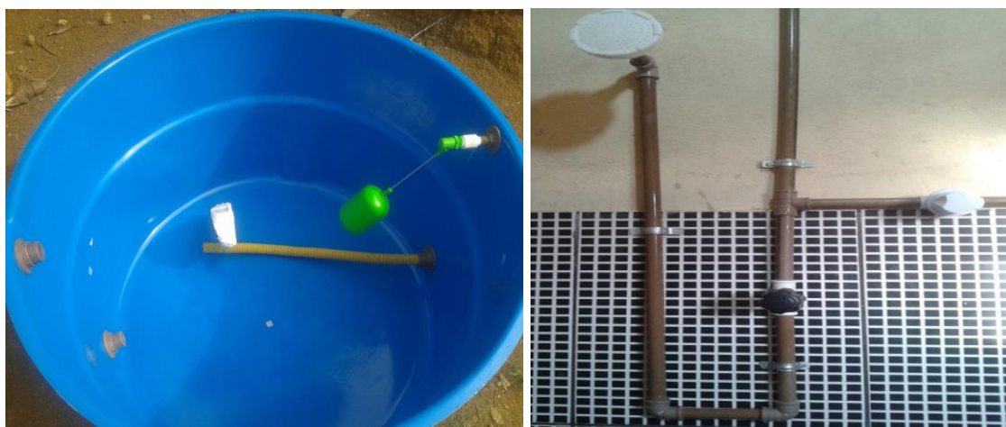
Figura 3 - Instalações na caixa d'água e no banheiro da residência
