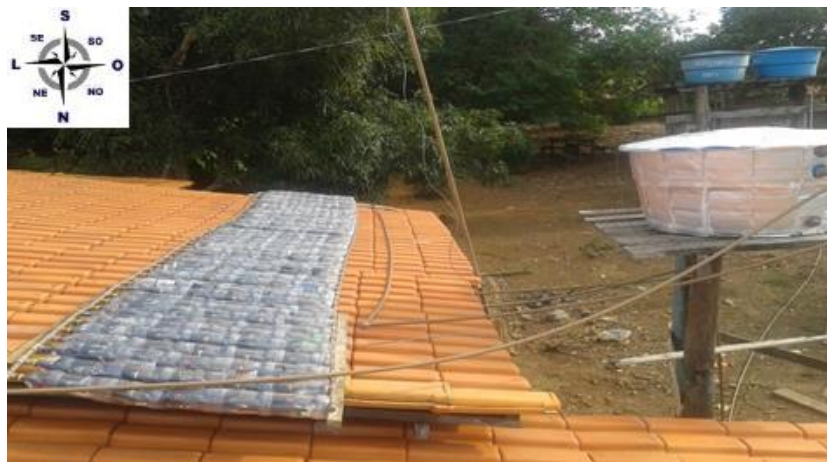
Figura 4 - Sistema Térmico Montado
