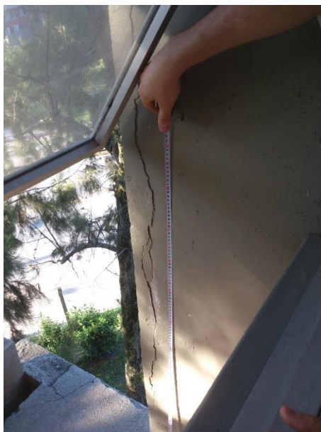
Figura 1: Concreto desagregado ainda ligado parcialmente ao pilar localizado no terceiro pavimento do bloco B na sala de aula 304.
