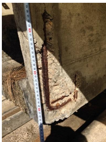
Figura 4: Armadura exposta em viga localizada na cobertura do bloco B.
