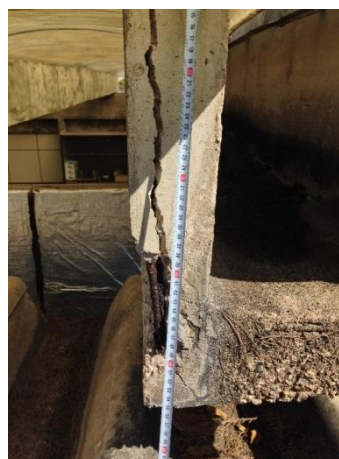
Figura 5: Armadura exposta em viga localizada na cobertura do bloco B.
