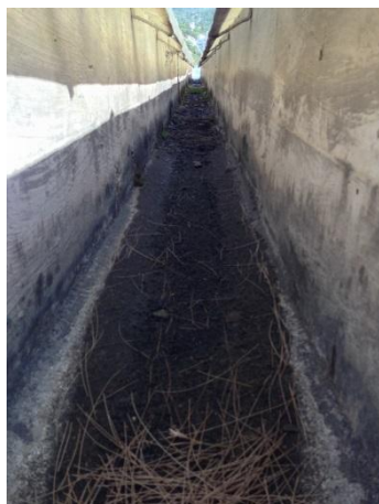
Figura 2: Calha parcialmente entupida localizada na cobertura do bloco B.
