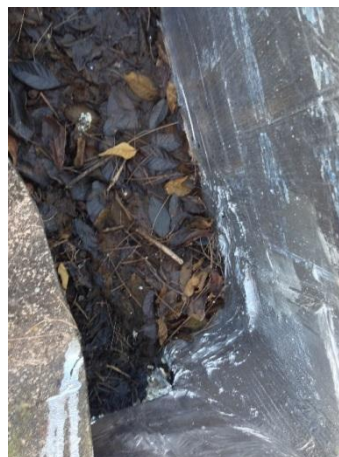
Figura 3: Tubo de queda com folhas localizado na cobertura do bloco B.
