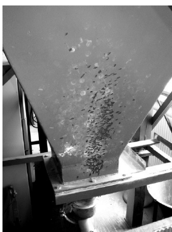
Figura 1 - Silo com marcas de impactos indicando problemas de escoamento (SCHULZE, 2007).
